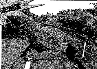
大積千本町地内の国道8号が崩落 51
