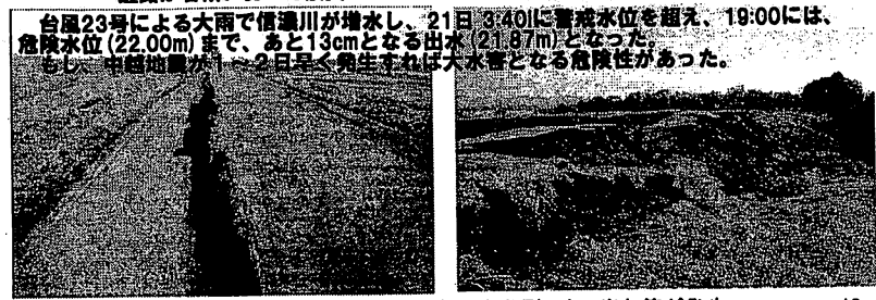
信濃川や中小河川の堤防に広範囲な亀裂、法面崩れ等が発生
