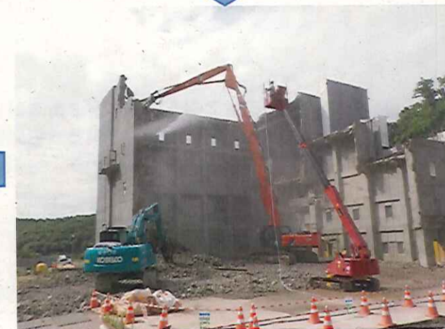
④【建屋解体(地上部)：本館棟(焼却炉)等】 実施時期：令和3年7月～8月
