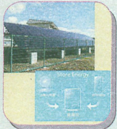
太陽光発電&蓄電池
