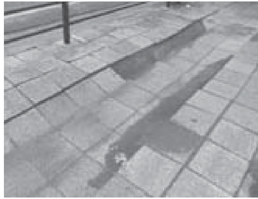
青山大通り商店会の歩道（修復前）
